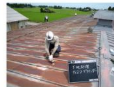
②下地処理 ディスクグラインダーで 表面の塗料や錆を削り 落とす
